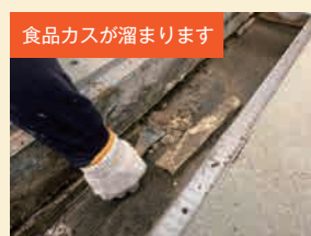
側溝のコンクリートの腐食
